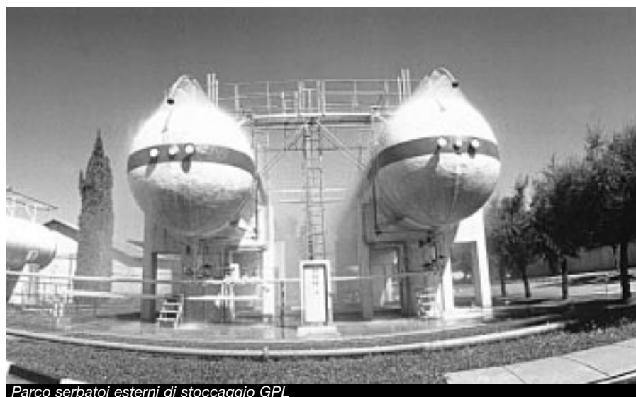
Parco serbatoi esterni di stoccaggio GPL
