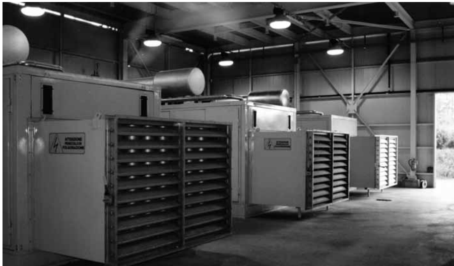
Sopra e nel riquadro i generatori e la sala controllo della società "Elettricità dei Rifiuti Urbani"
