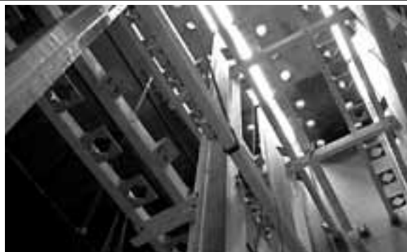
Travi di sostegno dei filtri delle ceneri provenienti dal boiler presso una centrale Enel a Brindisi
