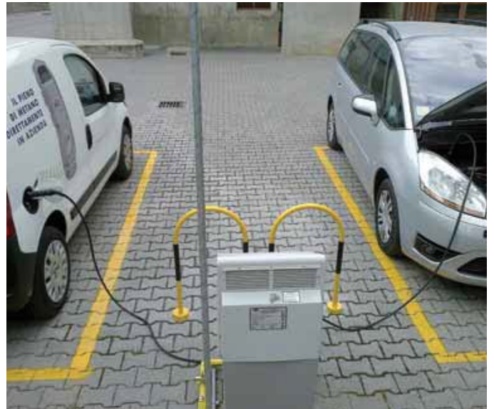
Un esempio di installazione di distributori "domestici" o aziendali di metano per autotrazione
