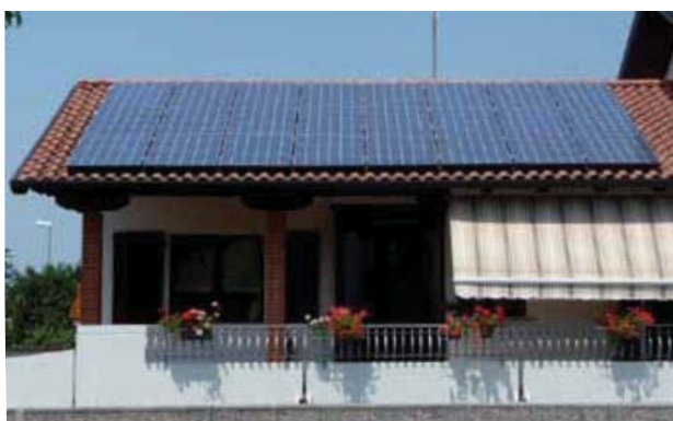
REMANZACCO - Impianto FTV da 5,76 kw
